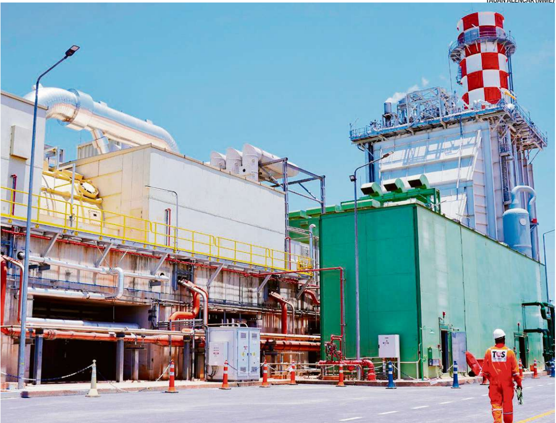
Usina instalada em Macaé (RJ) tem capacidade para 565 megawatts (MW) e iniciou suas operações no fim de 2023
